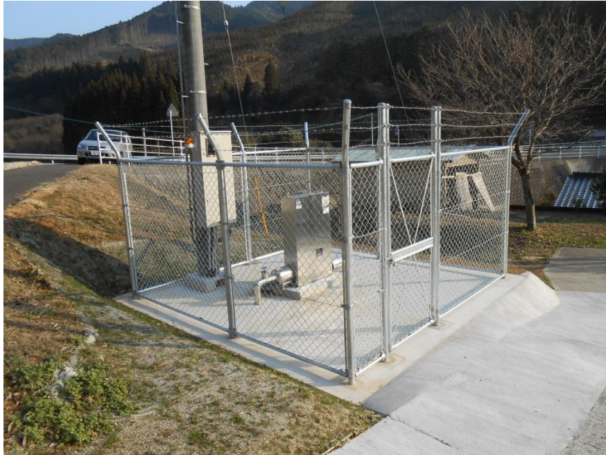
田頭送水ポンプ所（平成 25 年度整備）
