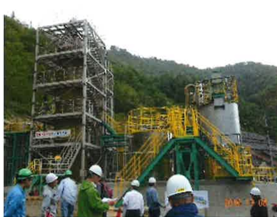
鹿間工場コース：排煙脱硫塔
