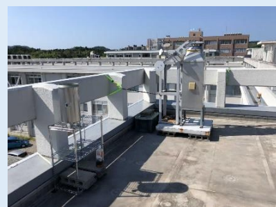
【屋上に設置したサンプリング装置】
