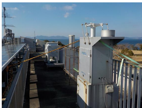
【水俣病情報センター屋上に設置してある降水採取サンプラーと雨量計】
